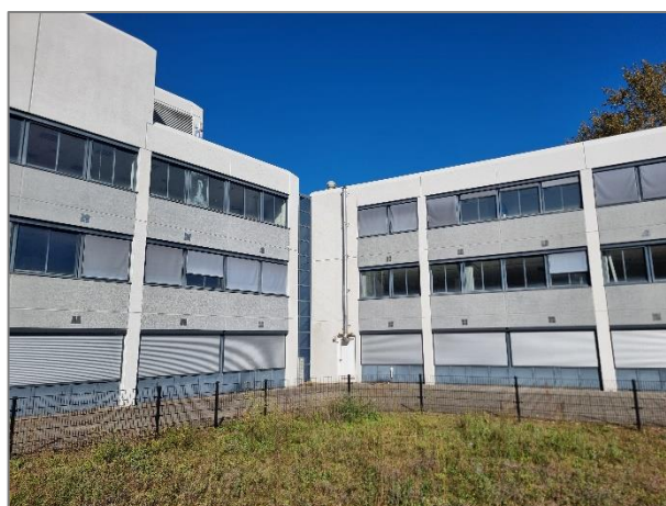
Afbeelding 5.4 | Achter de betonnen gevelplaten van het kantoorpand aan de Stationsweg 11 is in 2019 een kraamkolonie gewone dwergvleermuis vastgesteld van 130 dieren.
